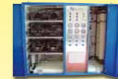
Groupe de surpresseurs à gaz de 12, 40 et 120 bar pour l'alimentation en air comprimé haute pression d'une unité de production.
